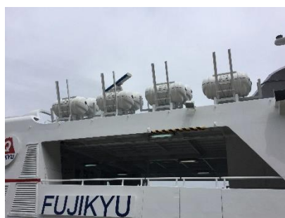
救命浮器の設置状況
